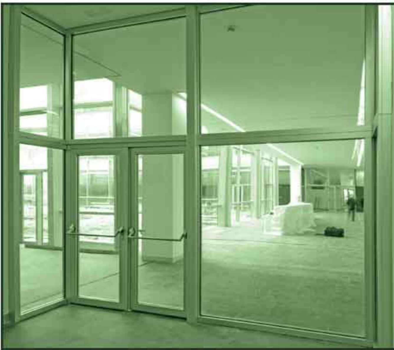
Nuevos Juzgados de Ciudad Real. Acristalamientos cortafuegos RF/EI-90
