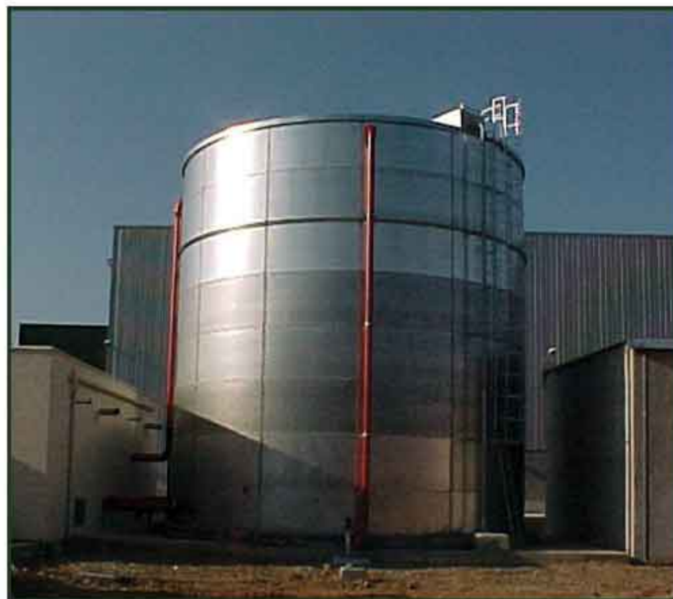
Depósito de acero galvanizado de gran capacidad
